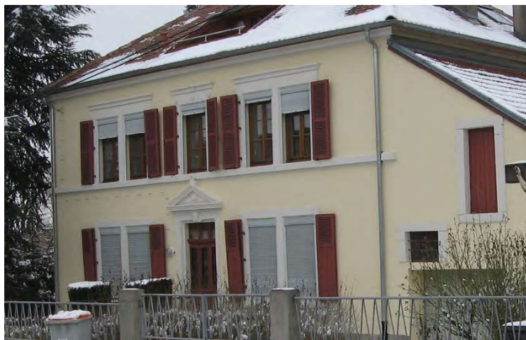
n°162 rue de Felpersviller : les fenêtres en bois divisées en 3 carreaux par vantail respectent le modèle d'origine. Les volets battants sont à persiennes à l'étage et mixtes au RDC.
