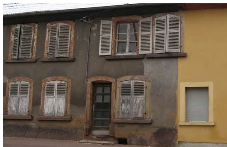
n°9 rue des Romains : les menuiseries d'origine sont les fenêtres à 2 vantaux divisés en 2 ou 3 carreaux par vantail, et les volets battants à persiennes (avec grandes lamelles) et de modèle mixte au rez-de-chaussée.
