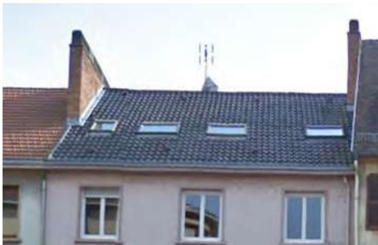
n°10 rue de l'Eglise : la tuile panne d'origine flamande et du nord de la France est à proscrire car elle n'est pas traditionnellement utilisée dans la région, de même que la couleur brune non naturelle.
