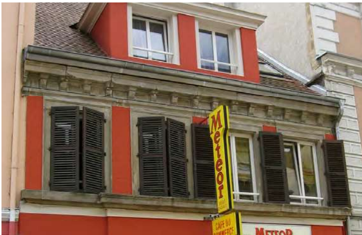
n°13 rue de Verdun : les éléments de modénature en pierre sont : la corniche avec ses modillons, les encadrements des baies avec chambranle, les bandeaux horizontaux délimitant les étages.
