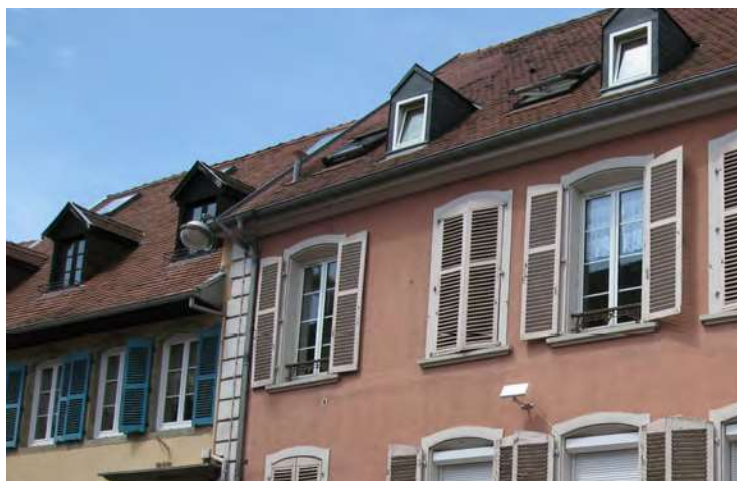
n°12-10 rue d'Or : couvertures en tuiles plates (biberschwanz), lucarnes en bâtières en partie basse.
