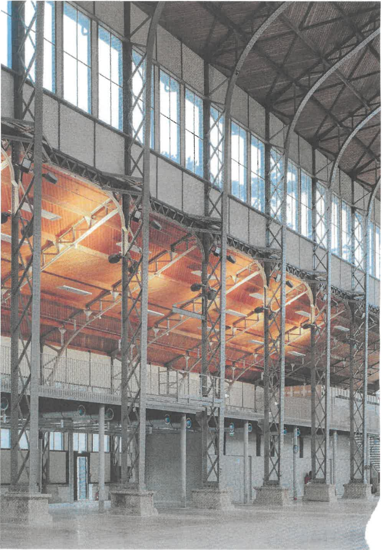
Dans le volume de chacun des bas-côtés réhabilités, a été créée une mezzanine ouverte, réalisée en plancher collaborant alliant un bac à une dalle de béton coulé.
