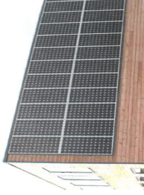
Panneaux photovoltaïques sur façades
